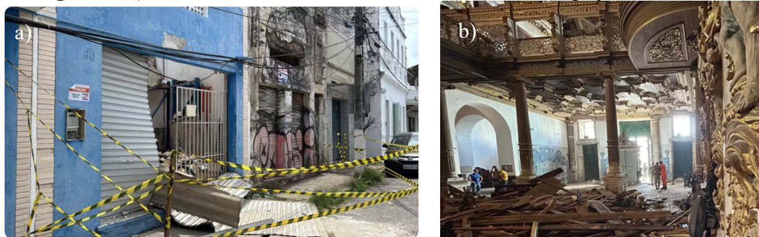
Figura 7: a) desabamento de edifício em Natal e b) teto de Igreja em Salvador
