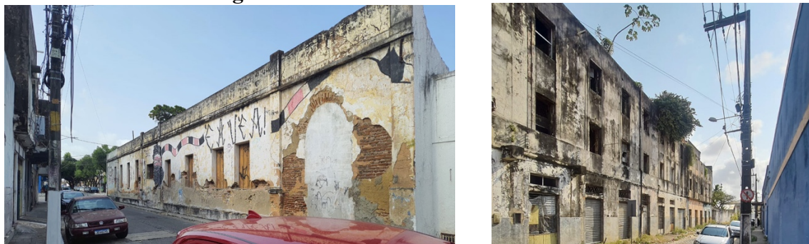
Figura 98: Edifícios abandonados na Ribeira
