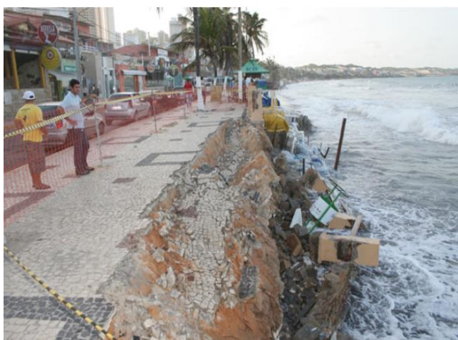
Figura 9. Calçadão de Ponta Negra desaba
